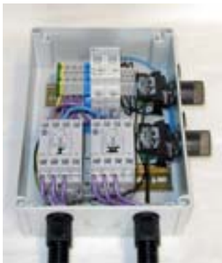
Bilde viser kontaktorskapp for 14 kW
